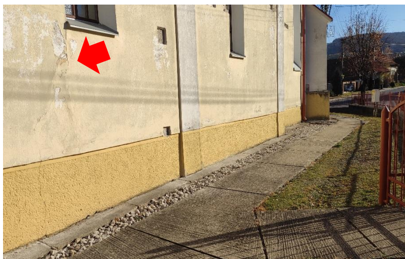
Obr. č.8 – Poškodenie fasádnych omietok zatekaním pod parapetom okna
