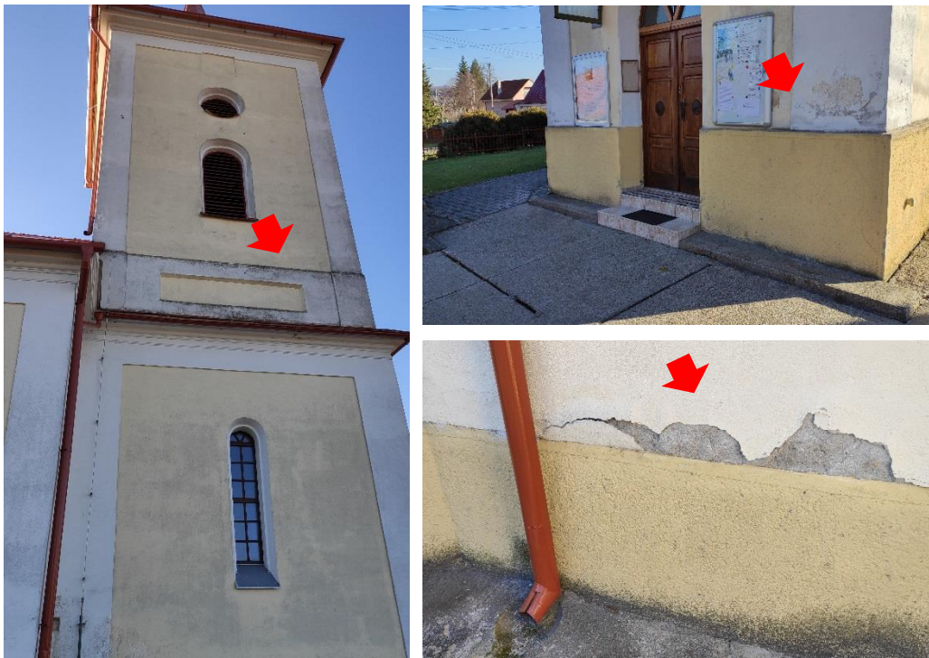
Obr. č.12 – Poškodenie fasádnych náterov a omietok zvýšenou vlhkosťou
