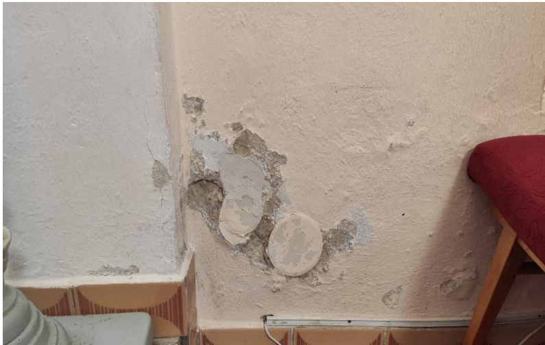
Obr. č.14 – Lokálne poškodenie vlhkosťou (sádra)
