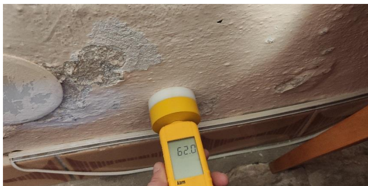
Obr.17 - Lokálne zistená zvýšená vlhkosť piliera
