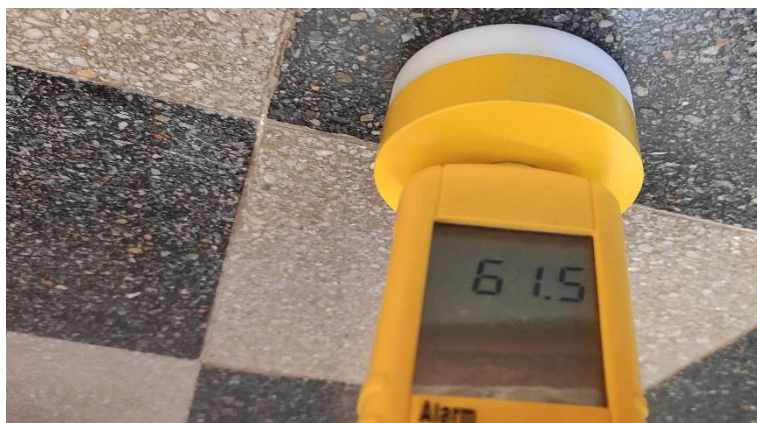
Obr.18 - Zvýšená vlhkosť podlahy svätyne
