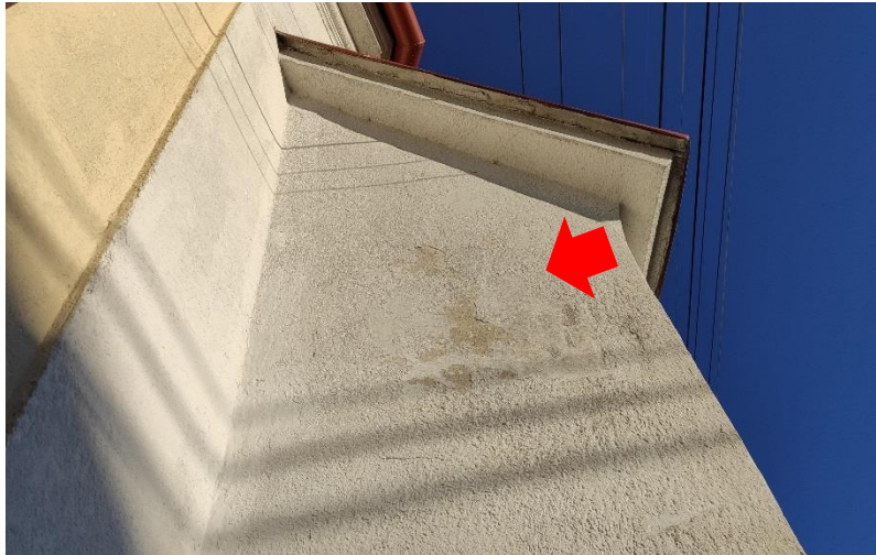
Obr. č.9 – Degradácia omietky na opornom múre zatekaním
