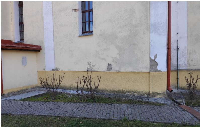
Obr. č.5 – Severozápadná časť fasády so zaplesnením povrchu
