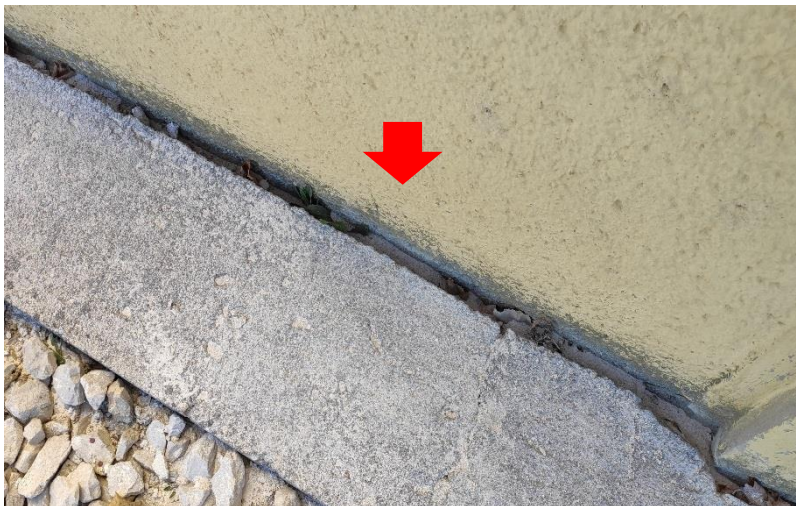
Obr. č.3 – Škára v styku betónového odkvapového chodníka a sokla
