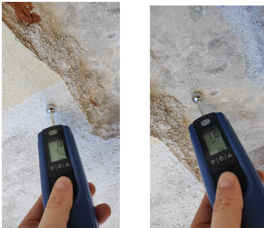
Obr. č.7 – Vlhkosť fasádnych omietok a jadrovej omietky po realizácii sondy
