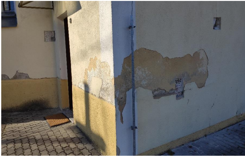
Obr. č.4 – Degradované omietky sakristie
