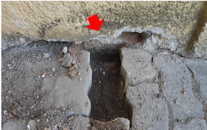
Obr. č.10 – Soklová časť bez zvislej hydroizolácie muriva - sonda
